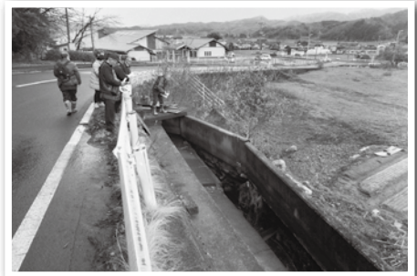
用水路の破壊後状況
