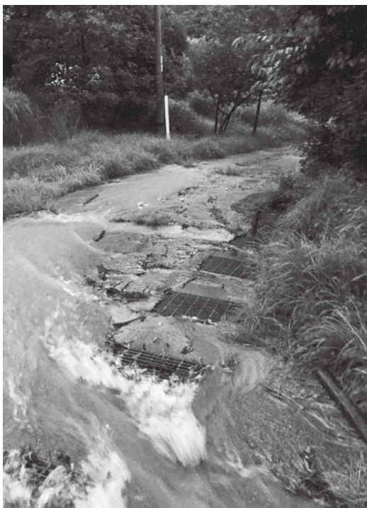
流路工が未整備の状況
