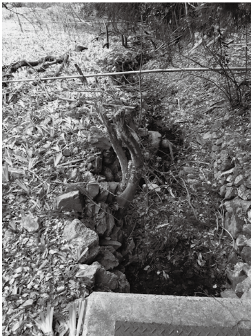
▲ 未整備の流路溝
