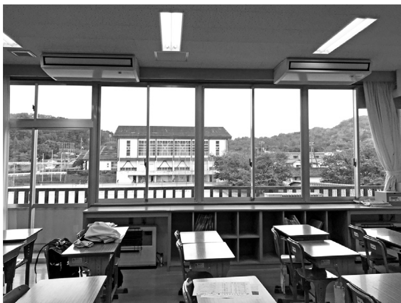
▲ 教室の天井に設置された空調機(八頭中学校)
