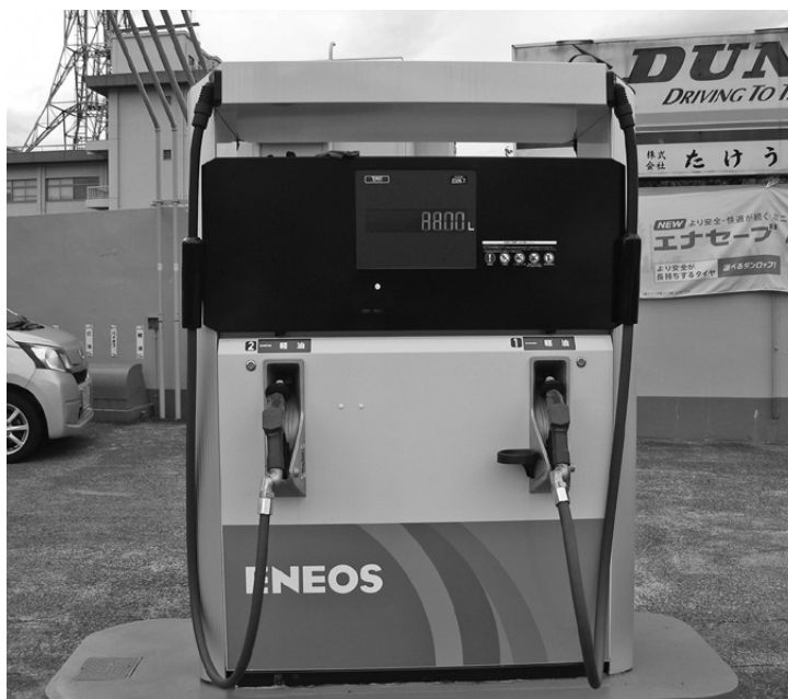
▲ 修理された計量器
