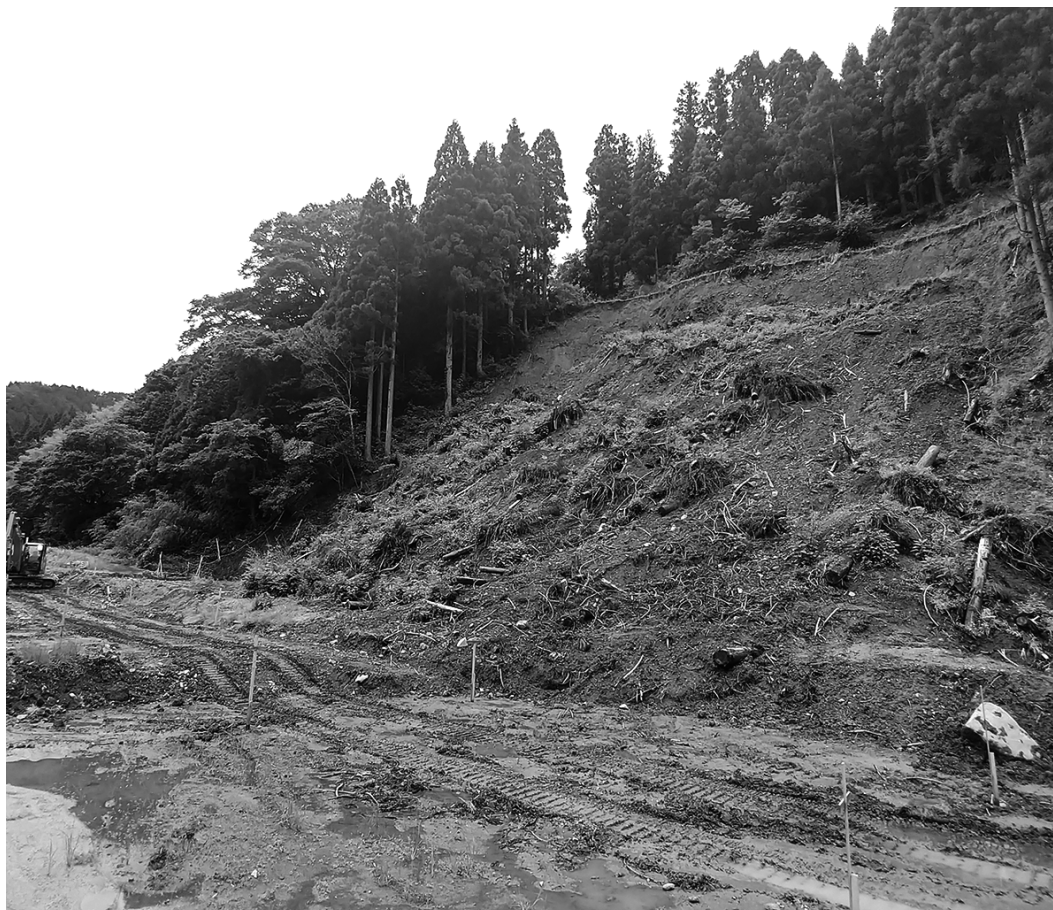
▲ 今なお復旧工事が続く昨年7月豪雨の被災現場(麻生地内)
