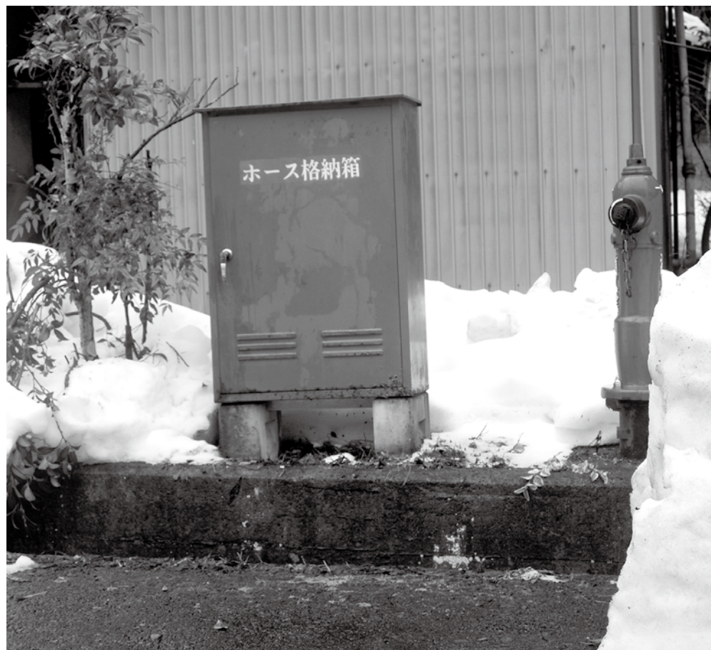
▲ 普段から消火栓の確認を
