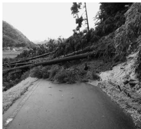
▲法面崩壊(麻生)
