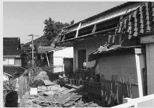
屋根の崩落現場（船岡保育所）
