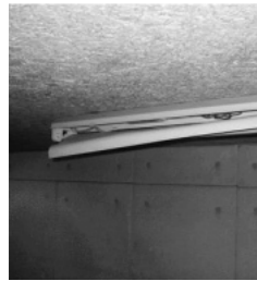
爆風で変形した振動コンベア室の照明
