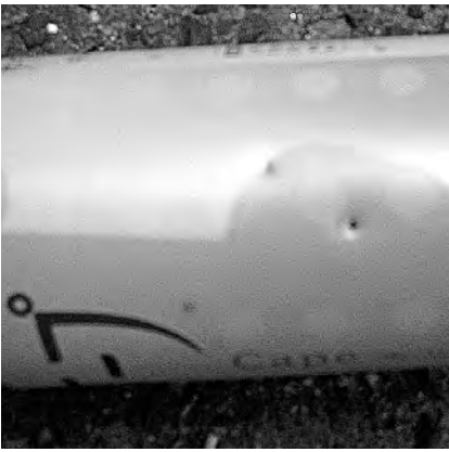
穴が小さすぎてガスが抜けない
