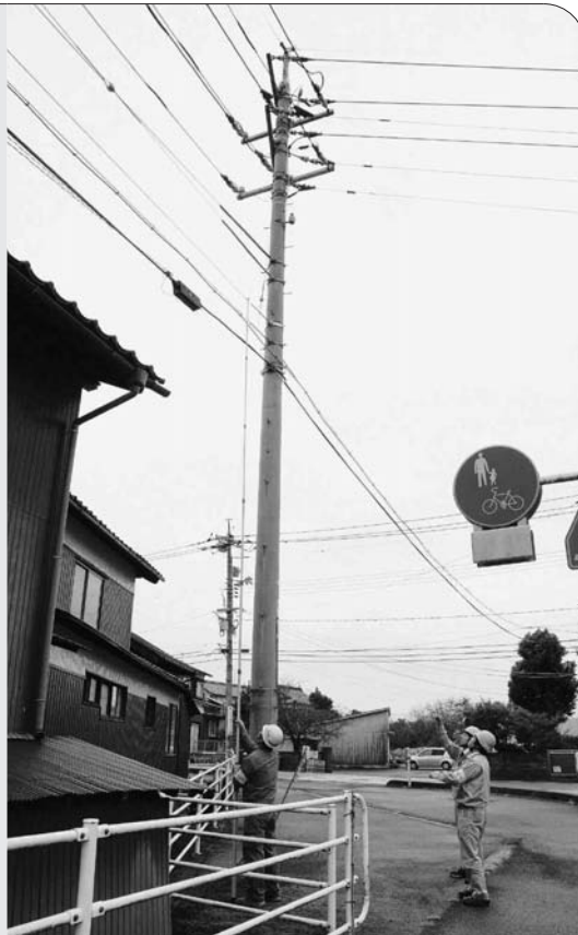
光ケーブルを架ける予定で、補強などの対策が必要な電柱を調査しています。
