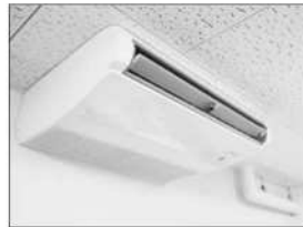
花部落 エアコン設備ほか
