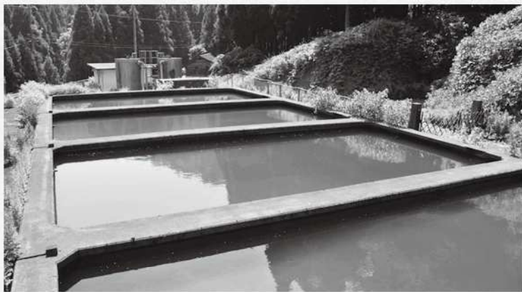
妻鹿野浄水場
