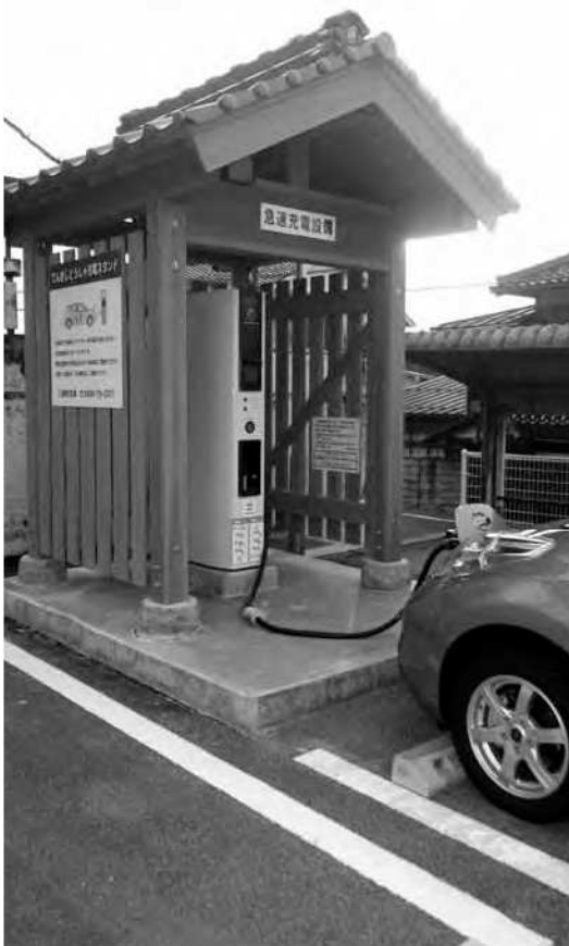
急速充電スタンド(本庁舎前駐車場)
