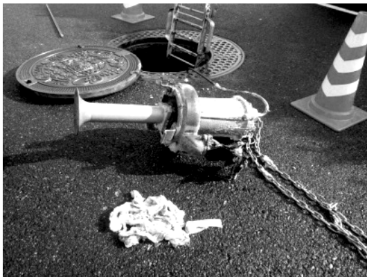
マンホールポンプに詰まっていたウェットティッシュの塊り
