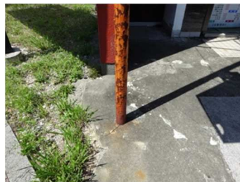
支柱の腐食が進行した状態
