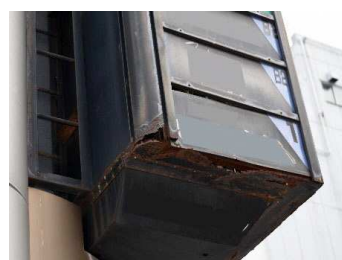
側板底面が腐食、破損した状態
