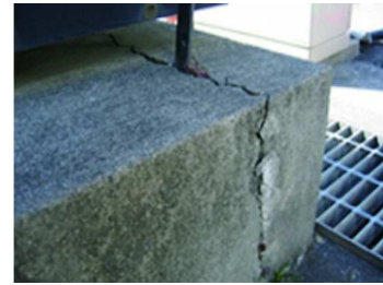
基礎にクラックが入った状態
