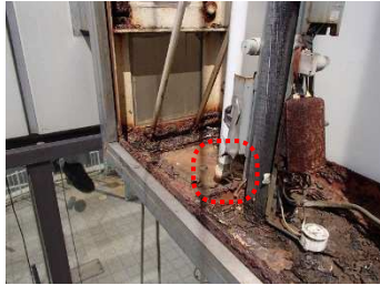
蛍光灯のホルダーが破損した状態
