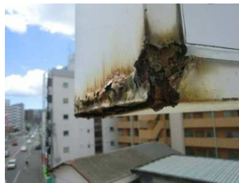
側板の腐食が進行した状態
