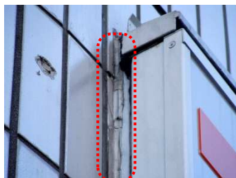
広告板と壁面との隙間のコーキングが劣化した状態
