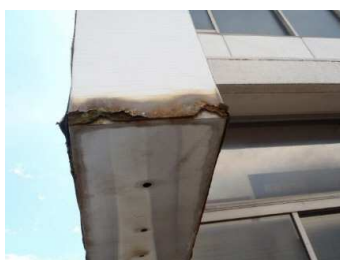
側板の腐食が進行した状態
