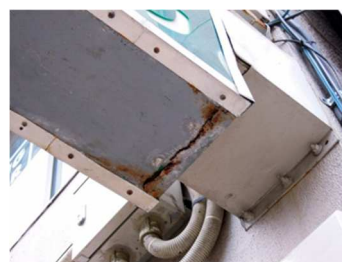
側板底面が破損した状態
