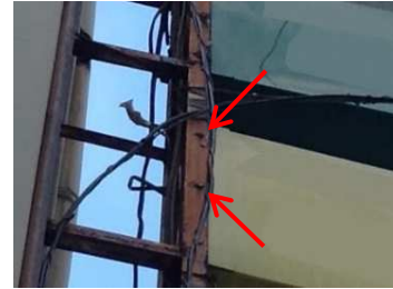
ボルトのゆるみや欠落した状態
