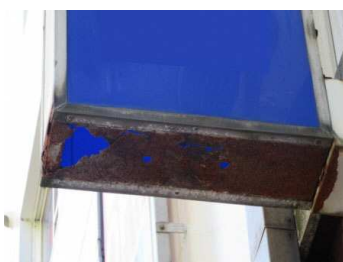
側板底面が腐食、破損した状態
