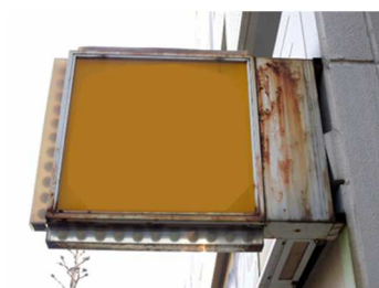
ブラケットカバーにさびが進行した状態
