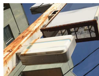
支柱にさびが発生した状態
