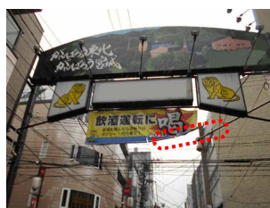
幕材を張る部材が破損した 状態
