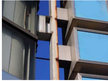
支持部が腐食した状態
