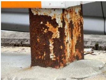
支柱根元の腐食が進行した状態
