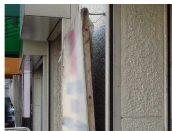
壁面との間に隙間が生じた状態
