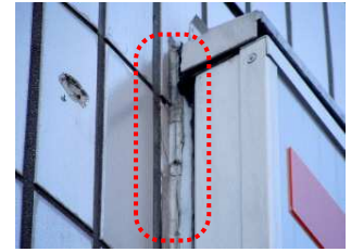
コーキングが劣化した状態
