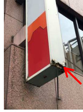
広告板底部の腐食が進行した状態
