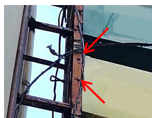
ボルトのゆるみや欠落した状態
