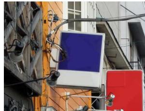
上部構造全体が傾斜した状態
