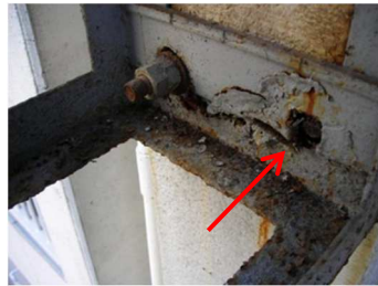
所定の場所にアンカーボルトがない状態
