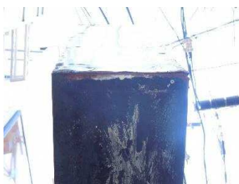
側板底面にさびが発生した状態
