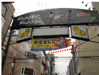
幕材を張る部材が破損した状態
