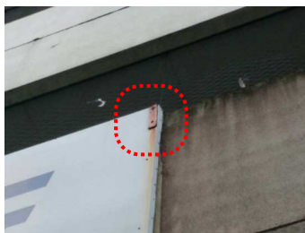
金具が劣化した状態
