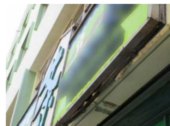
側板底面が破損した状態
