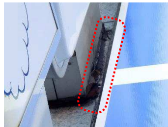
コーキングが劣化した状態
