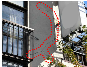
壁面にひびが生じた状態
