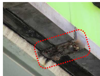
金具が劣化した状態
