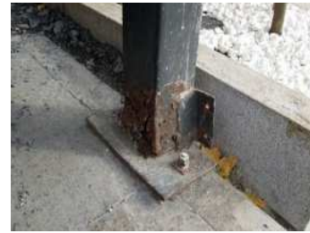
支柱根元の腐食が進行した状態
