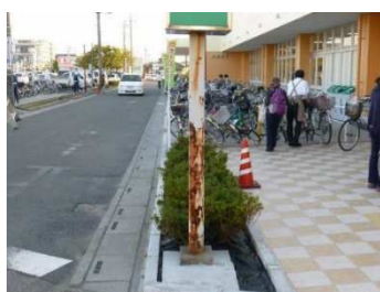
支柱の腐食が進行した状態
