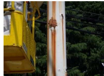
支柱の腐食が進行した状態
