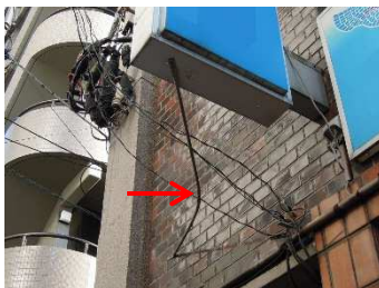
振れ止め棒が変形した状態
