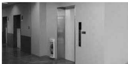
船岡小学校に設置されたエレベーター
