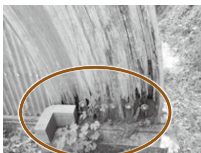
腐朽の進行した集成材と金属基部
