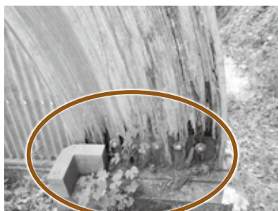
腐朽の進行した集成材と金属基部
