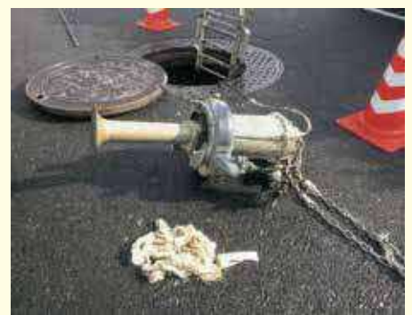
ポンプに詰まっていたウェットティッシュのかたまり
