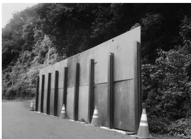
▲ 町道東鍛冶屋線崩落か所
