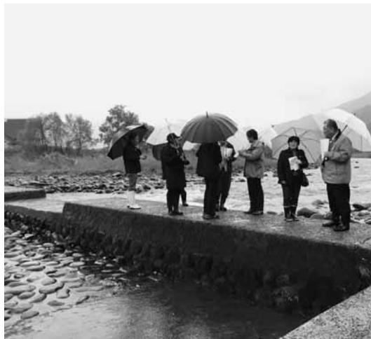
▲ 災害にあった金崎頭首工を現地確認(皆原)
