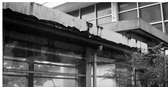
▲修繕が必要な学校施設
