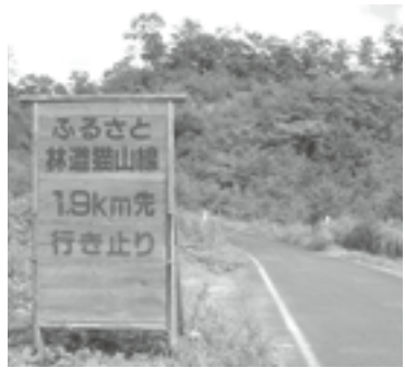
▲工事中断中の猫山林道
