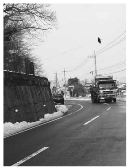
▲くずれ岩付近道路
